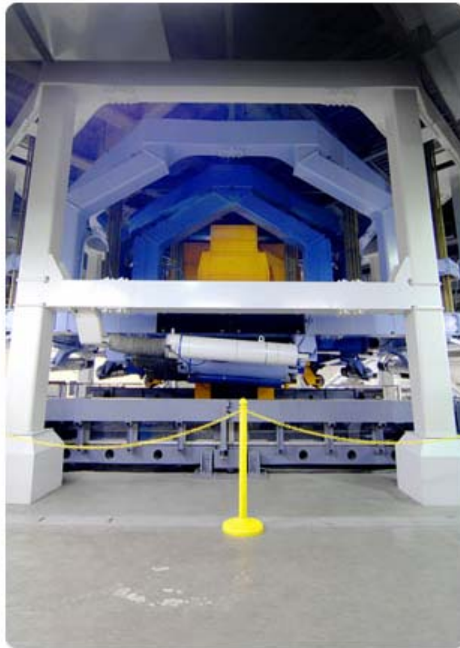
横浜ランドマークタワーの制震装置
